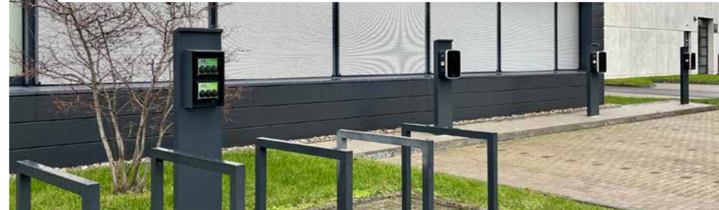
Ladesäulen für die elektrische Mobilität. EK setzt bei seinem Angebot auf nachhaltige Lösungen.
